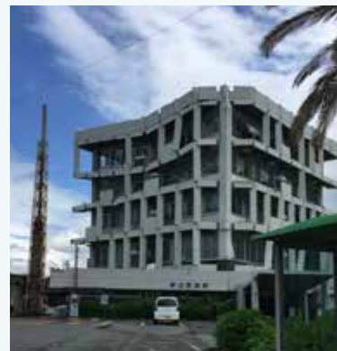
地震により被害を受けた宇土市庁舎
